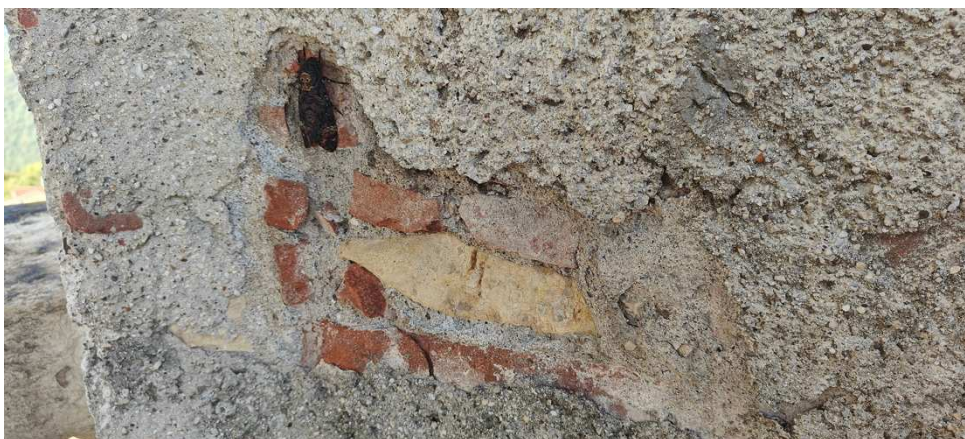
Foto 7 – interno cella campanaria – porzione di intonaco distaccata, si nota l'uso misto di laterizio e pietra.
