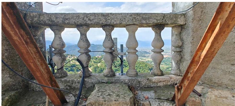
Foto 12- visione dei punti di scarico del castello ferreo nel lato nord, da notare la balaustra rotta a sinistra in corrispondenza del piedritto.
