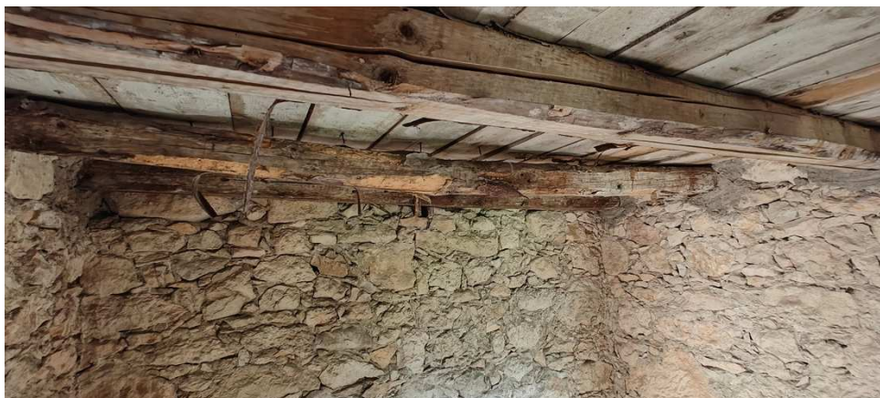
Foto 13 – terzo impalcato, trave lignea in evidente stato di sofferenza.
