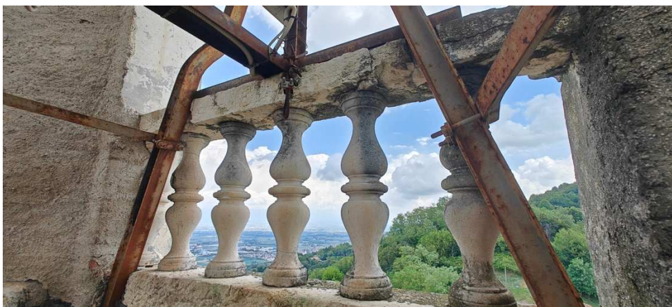
Foto 10 – particolare della balaustra est – da notare le rotture e la perdita di materiale e l'assenza dell'ultimo semi-balaustino a sinistra.
