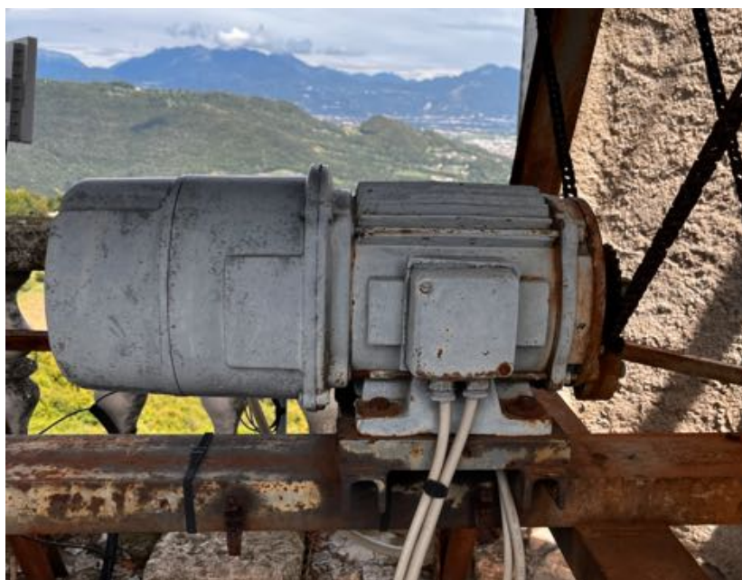
Motore installato in cella campanaria
