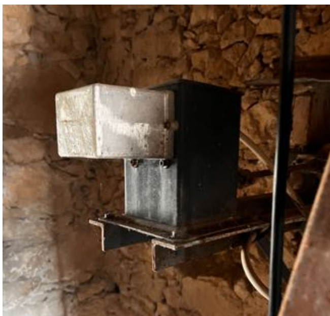
Servomotore orologio da torre
