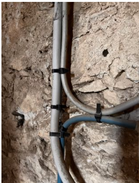
Linea elettrica campane
