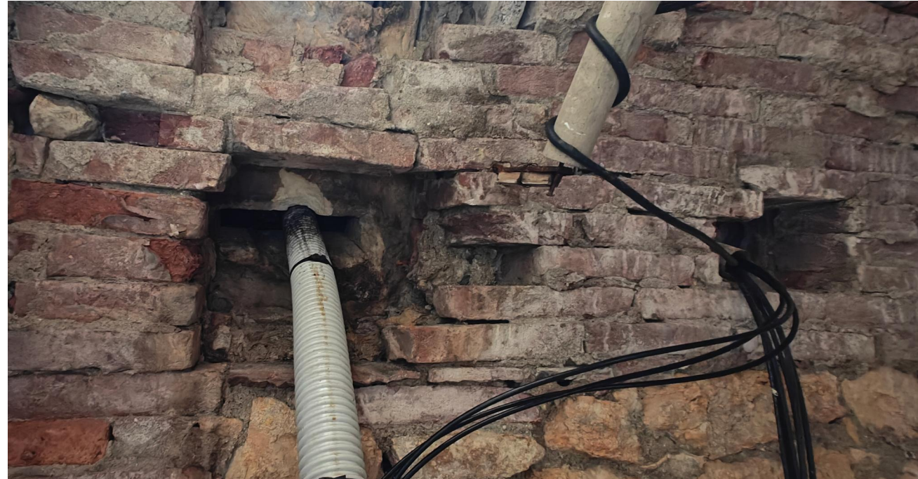
Vista 14 - dettaglio lesioni volta
