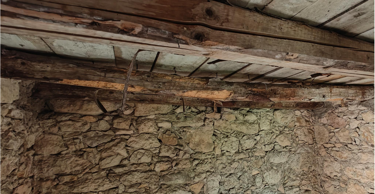
Vista 11 - particolare trave marcesecente
