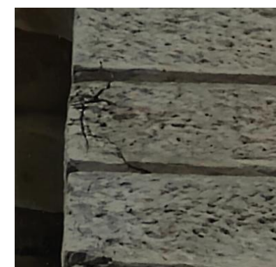
Intervento A (particolare bugna lesionata)
