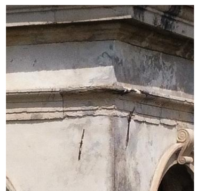
Intervento B (particolare cornice parzialmente disgregata)
