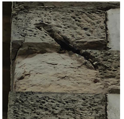
Intervento D (particolare bugna disgregata)
