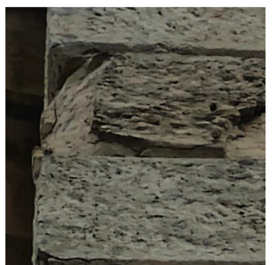
Intervento C (particolare bugna con mancanza e disgregazione)
