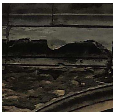
Intervento C (particolare cornice con mancanze)
