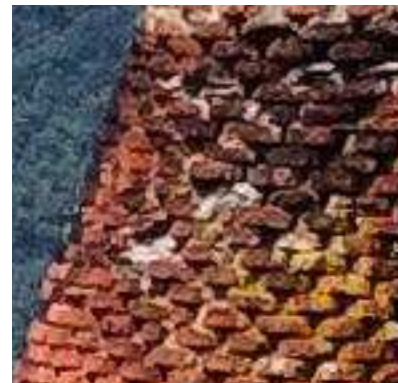
Intervento B (particolare elementi disgregati e mancanti)
