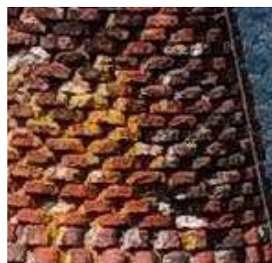
Intervento A (particolare elementi disgregati)
